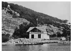
Im Neptunhafen wird ein neues Bootshaus gebaut, die jährliche Platzgebühr an die Gemeinde beträgt 1 Franken.
